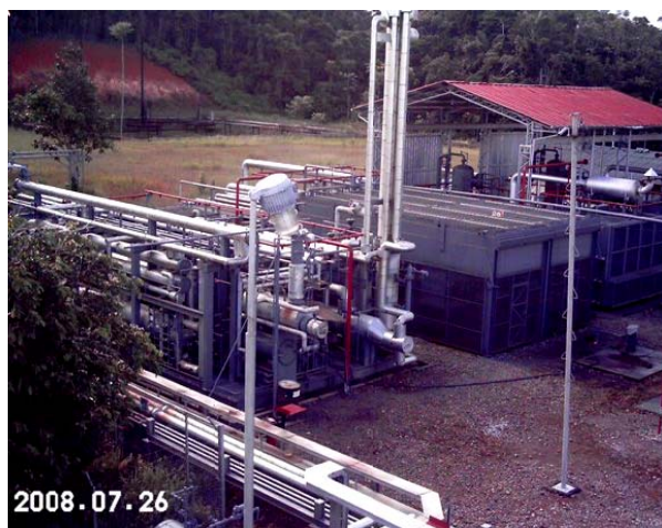
Fotografía N° 2. Sistema de Glicol (SKID A). 2008
