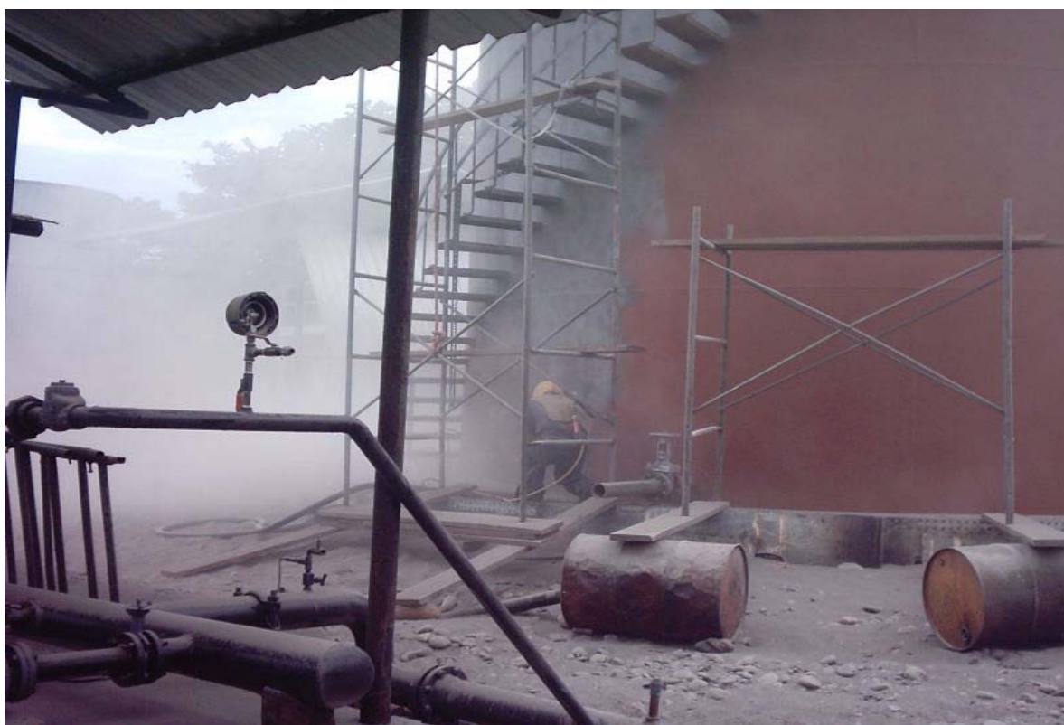
Proceso de limpieza exterior del tanque de 500 barriles, se observa contaminación del recurso suelo, aire y ambiente. Método de sandblasting
