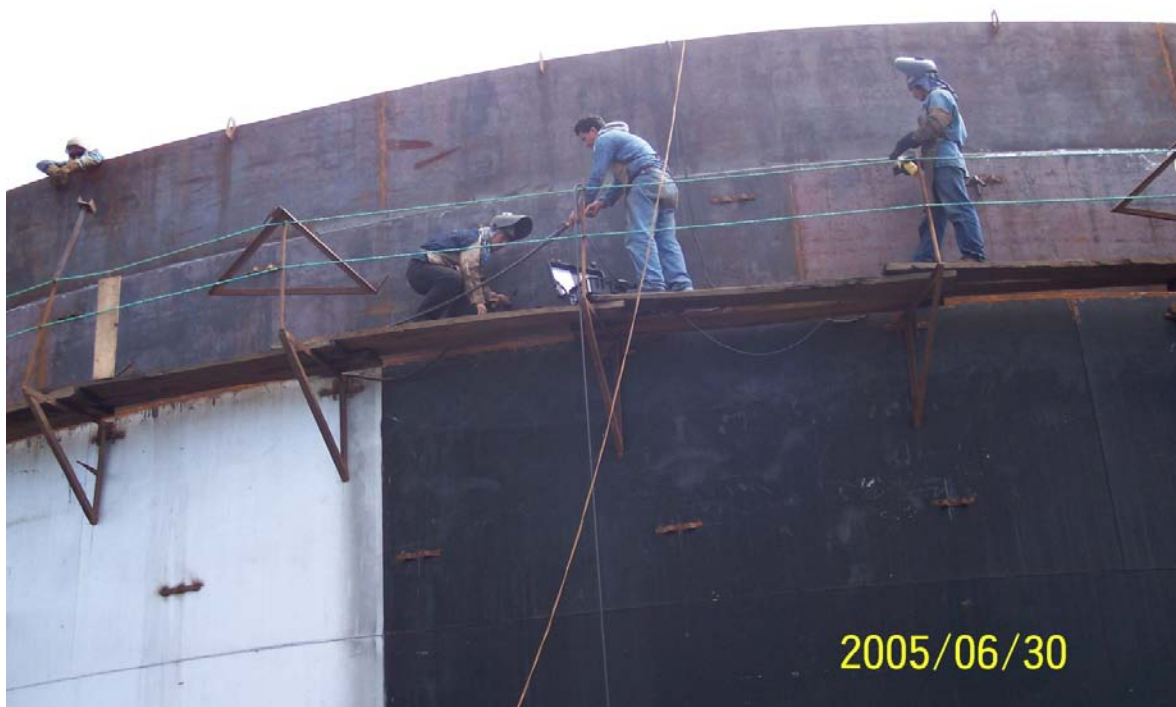
Reparación de tanque soldadura de última virola, falta de elementos de seguridad
