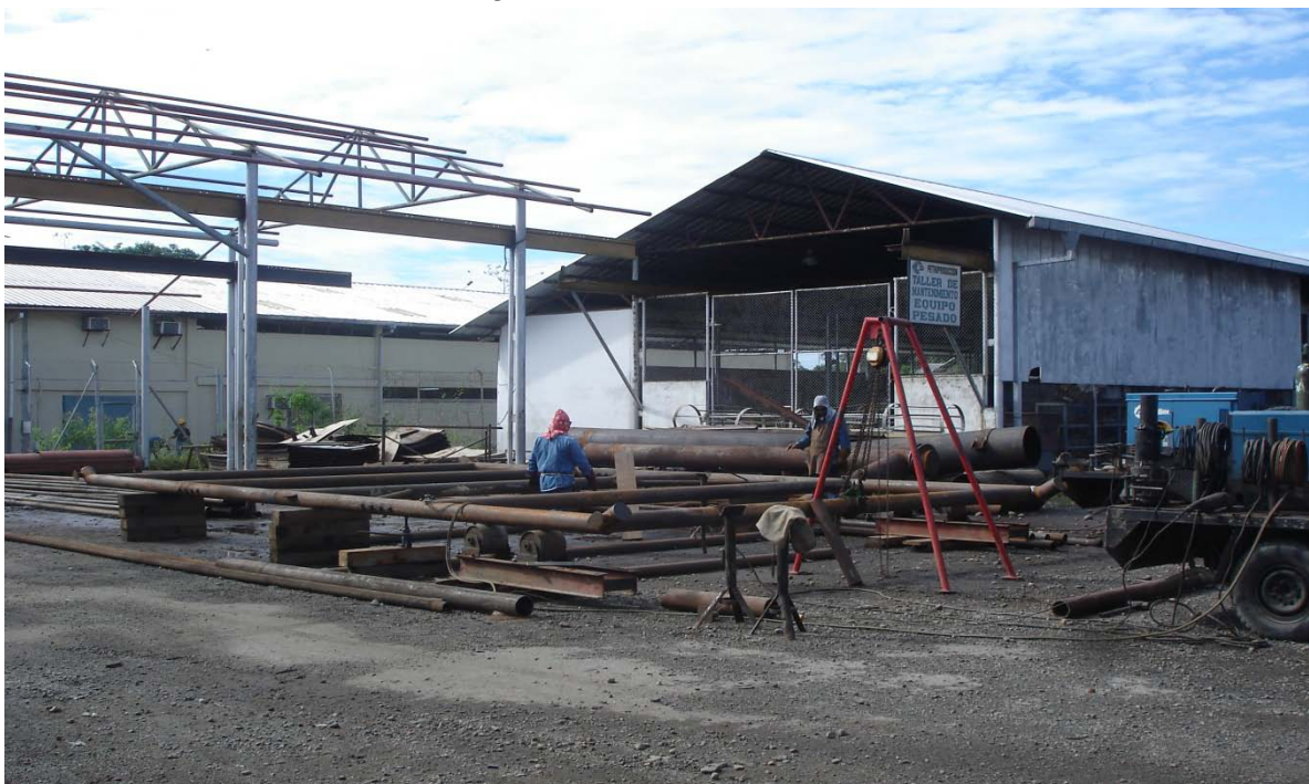
Contaminación del recurso suelo, aire con láminas y tubería para preparación de skid
