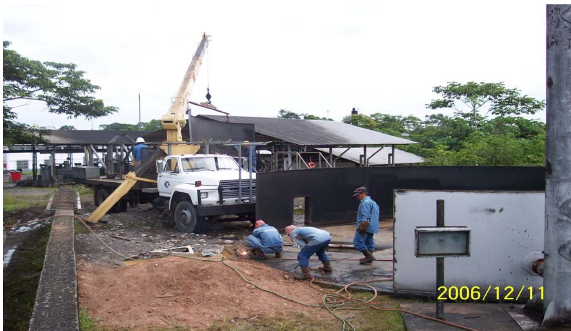
Reparacion tanque de 500 barriles, fondo de tanque corte de laminas, se observa contaminacion del recurso suelo, aire con gases de combustion de equipos de suelda
