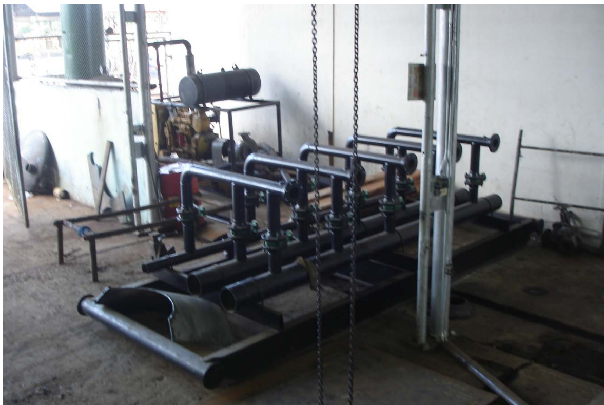
Equipo de superficie terminado
