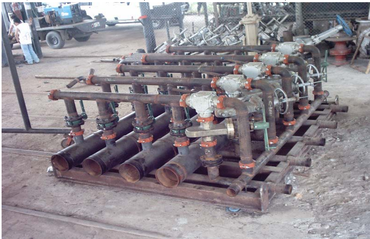
Contaminación recurso suelo, proceso de terminación de trabajos
