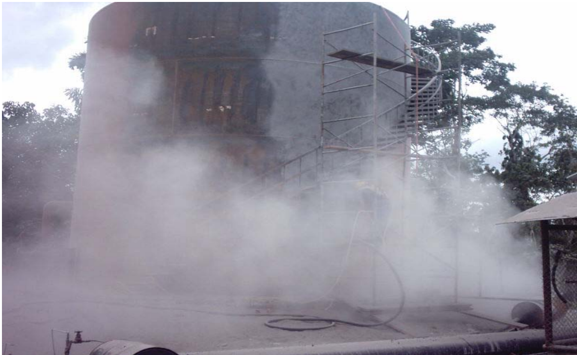
Proceso de limpieza exterior del tanque de reinyeccion de agua, sandblasting contaminacion del suelo, aire, ambiente y salud trabajadores
