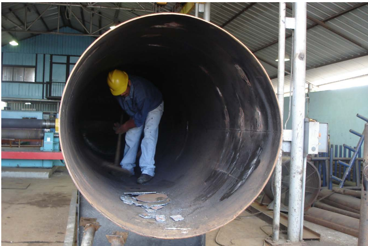
Proceso de limpieza interna de separador en reparación, contaminación del recurso suelo con desperdicios de metal y restos de petróleo
