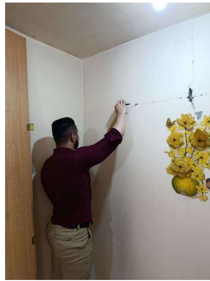
5.6. Medición de fisuras en muro de la Vivienda 29 - código 7760, calle H y calle 4.
