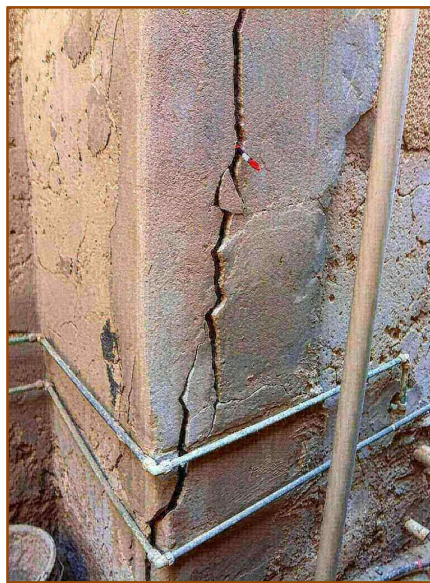
Ilustración 2. Grieta vertical en elemento de hormigón
