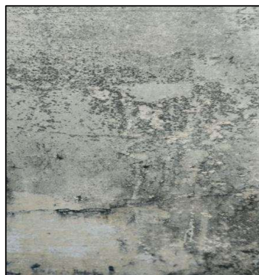
[Humedad – Fisura – Eflorescencia - Muro]
