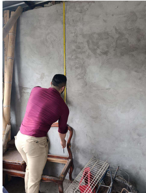
5.8. Medición de grieta en muro de la vivienda 28, código; 7761, calle H entre calle 3 y calle 4.
