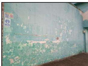
[Eflorescencia – Fisura - Muro]
