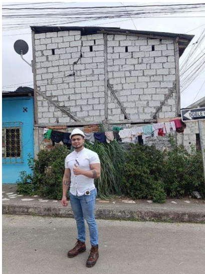
5.15. Vivienda que presenta grieta crítica en la Calle 5 transversal del Barrio Unidos por el Cambio entre la calle H y calle 5 (longitudinal).
