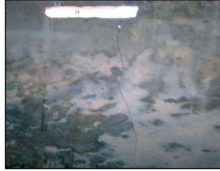
[Fisura – Eflorescencia - Muro]
