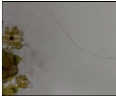
[Losa – Humedad - Fisura]
