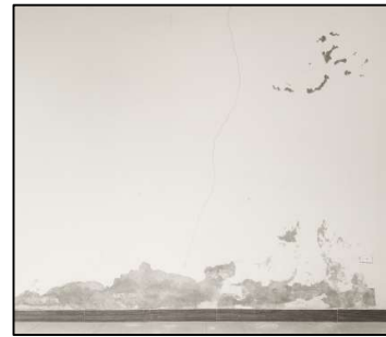
[Muro – Fisura - Eflorescencia]
