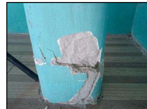
[Grieta – Desprendimiento - Columna]
