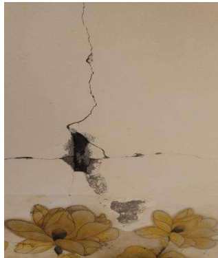
[Grieta – Fisura - Muro]
