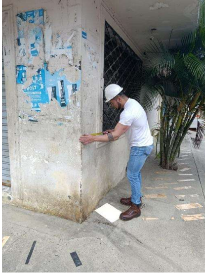
5.1. Medición de fisuras fachada lateral en la Vivienda 29 - código 7760, calle H y calle 4.
