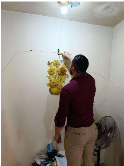
5.5. Medición de grieta en muro de la Vivienda 29 - código 7760, calle H y calle 4.
