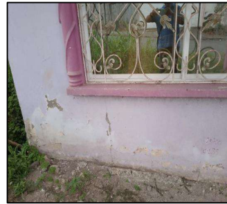
[Grieta – Fisura - Muro]
