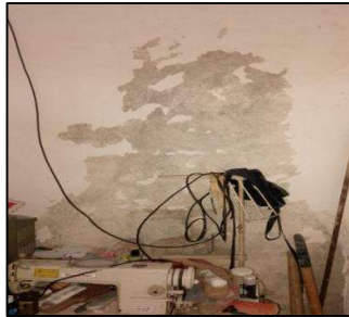
[Fisura – Eflorescencia - Muro]
