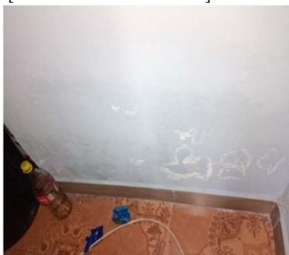
[Humedad - Fisura - Muro]
