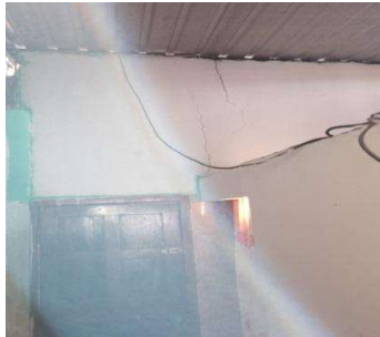
[Grieta – Fisura - Muro]
