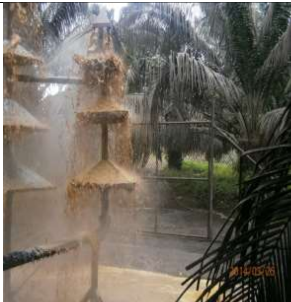
Torre de enfriamiento del efluente
