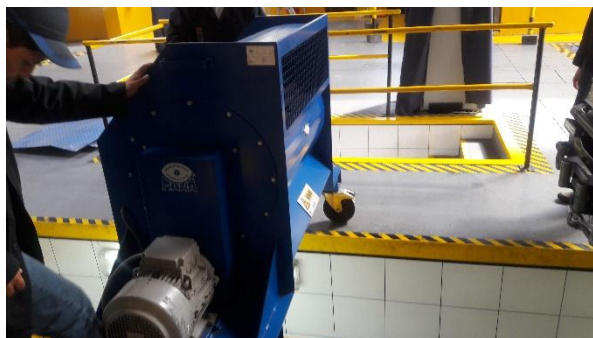
Figura 18. Ubicación del ventilador
