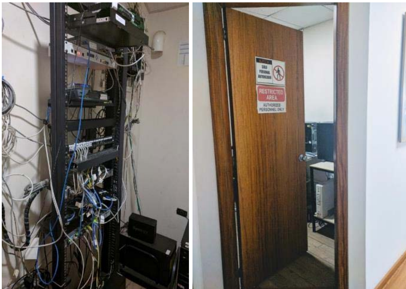
Figura 25. Acceso área de servidores y RAC
