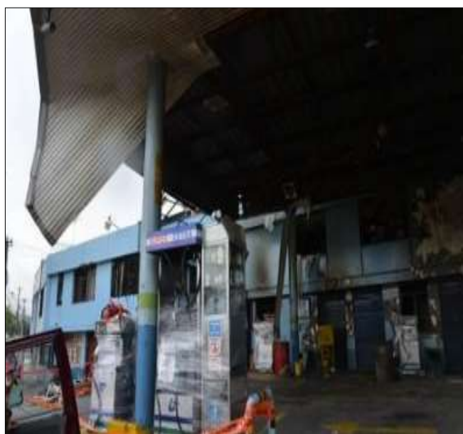
Fotografía 15: Daños en las instalaciones de la Estación de Servicio por la onda expansiva
