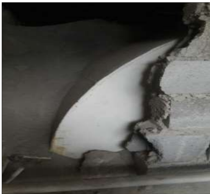
Fotografía 9: Cubetos de Tanques de Almacenamiento
