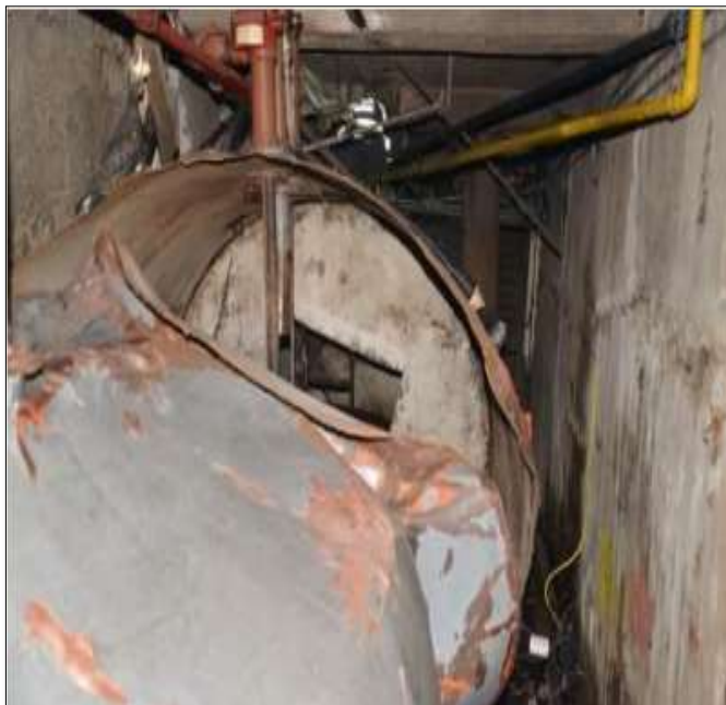
Fotografía 14: Tanque de Almacenamiento de Diésel (después de la Explosión)
