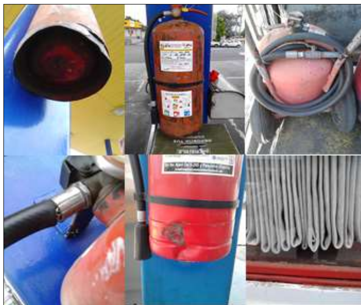
Fotografía 11: Equipos de Extinción de Incendios
