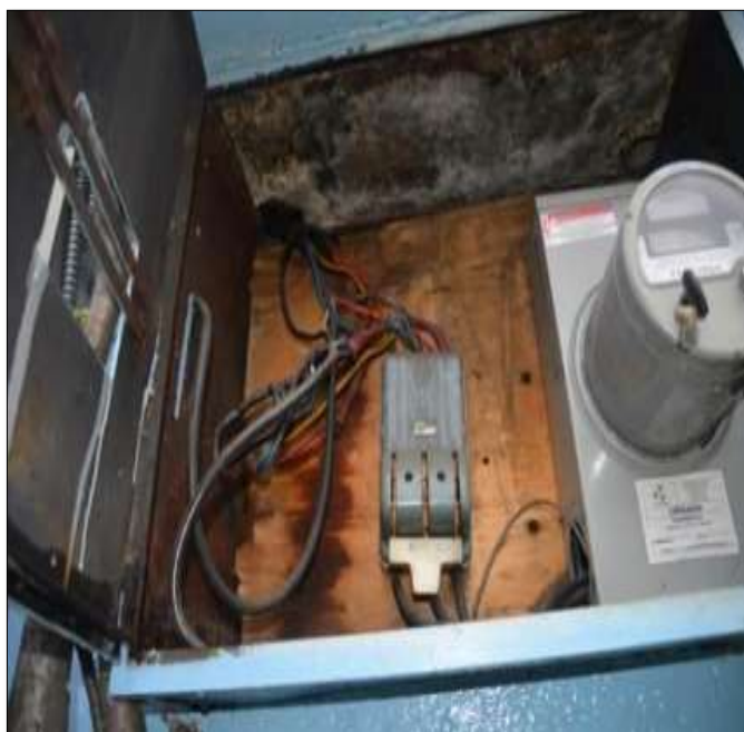
Fotografía 12: Medidor de Energía Eléctrica
