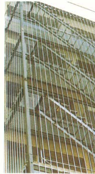
Escalera de emergencia instalada en el exterior del edificio.
