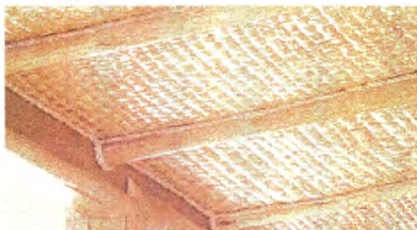
Foto #8: Tumbado cubierto de esteras
