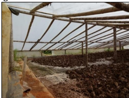
Figura 8. Techado Piscinas de Secado
