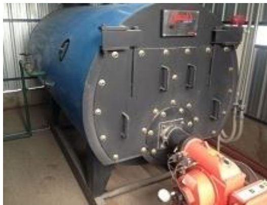
Figura 9. Caldero (Vista externa)
