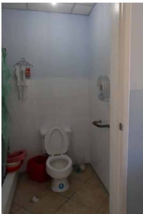
Foto 33. Baño con inodoro tipo B
