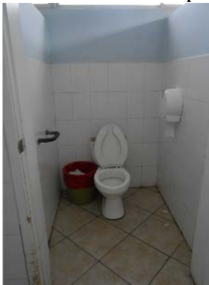
Foto 32. Baño con inodoro tipo A
