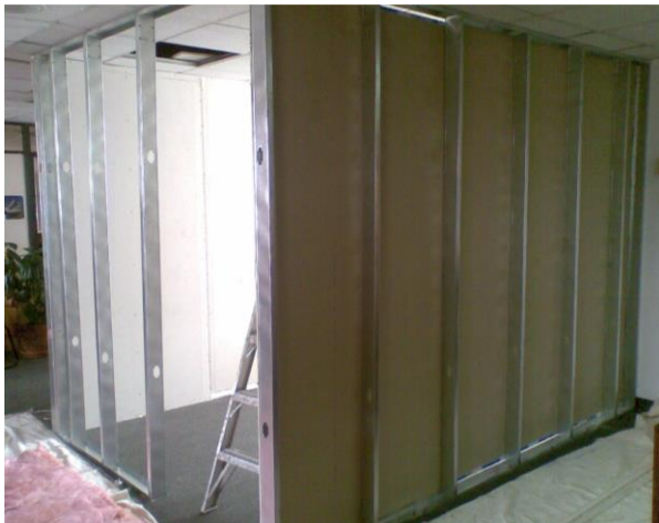
Fig. #32 Construcción del Cuarto de Servidores Realizado por: Patricia Malitasig
