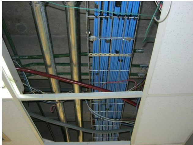
Fig. #38 Escalerilla Principal con distribución de la red de datos Realizado por: Patricia Malitasig
