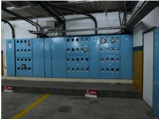
Fig. #7 Tablero Principal Edificio Belmonte Realizado por: Patricia Malitasig
