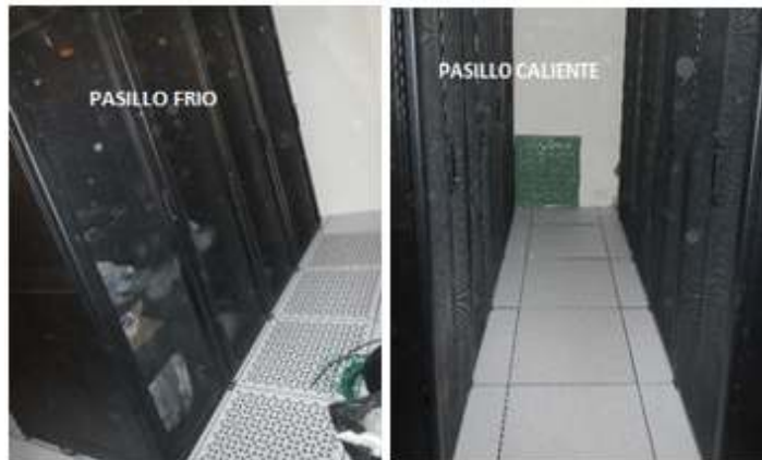
Figura 51: Pasillos Calientes y Fríos Autor: Andrés Díaz
