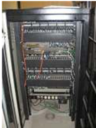
Figura 9: Rack Secundario C-T-P3 en Obras Públicas Autor: Marcelo Solís
