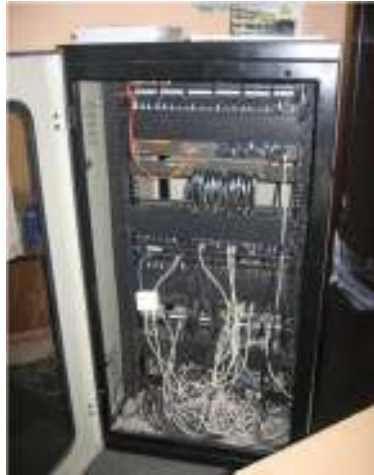
Figura 7: Rack C-T-PB Secundario en Tesorería Autor: Marcelo Solís
