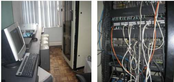
Figura 6: Cuarto de Equipos y Rack Principal de Comunicaciones Autor: Marcelo Solís
