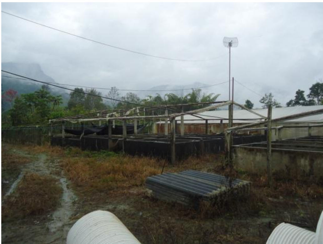
Figura 12 Estanques sin funcionamiento.
