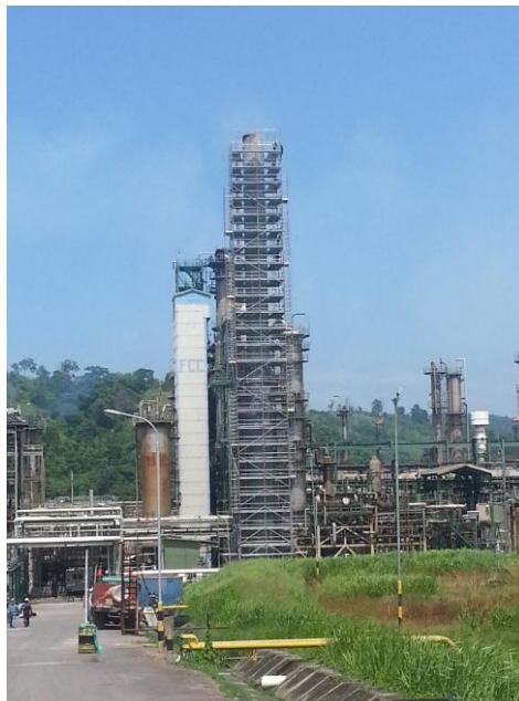
Fotografía 1. Unidad de Fraccionamiento Catalítico FCC
