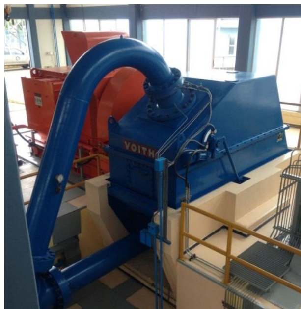
Ilustración 11: Turbina y generador eléctrico La Mica
