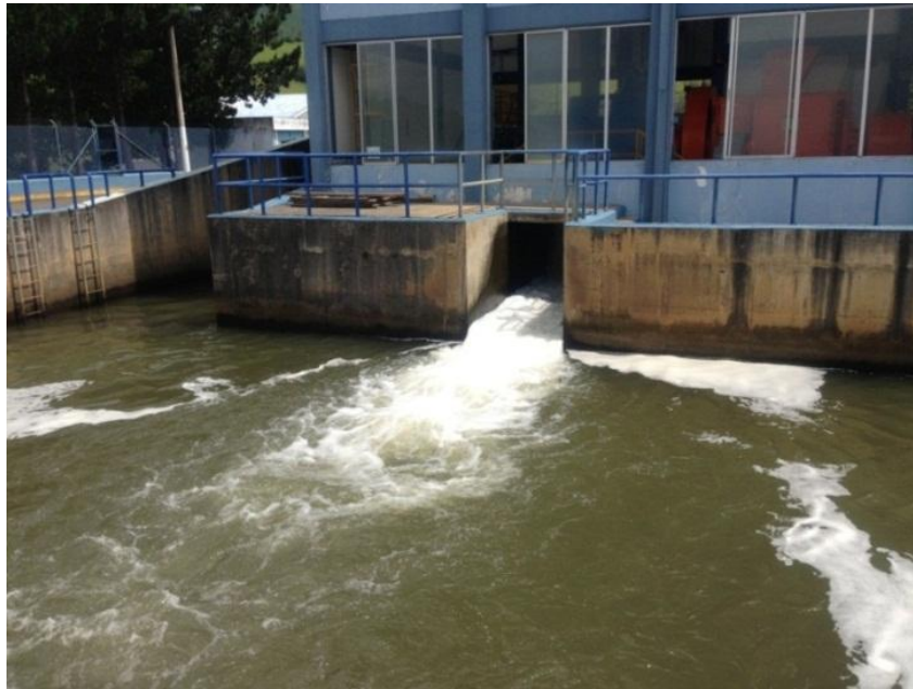
Ilustración 12: Reservorio de salida Sistema La Mica
