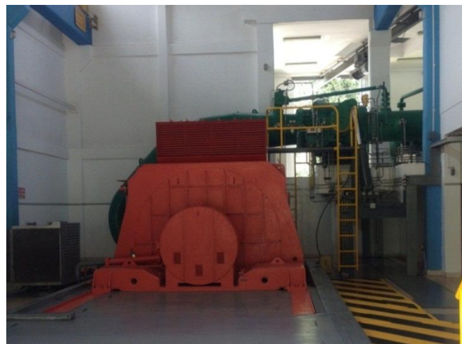
Ilustración 6: Generador Eléctrico Recuperadora
