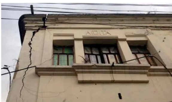
Figura 5.- Daños no estructurales en una edificación
