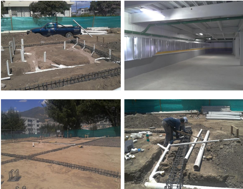
Ilustración 34. Instalaciones cruzando cadenas de cimentación
