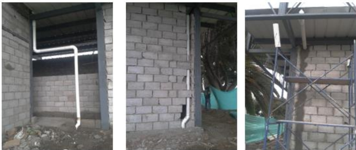
Ilustración 35. Tuberías de descarga embebidas en paredes
