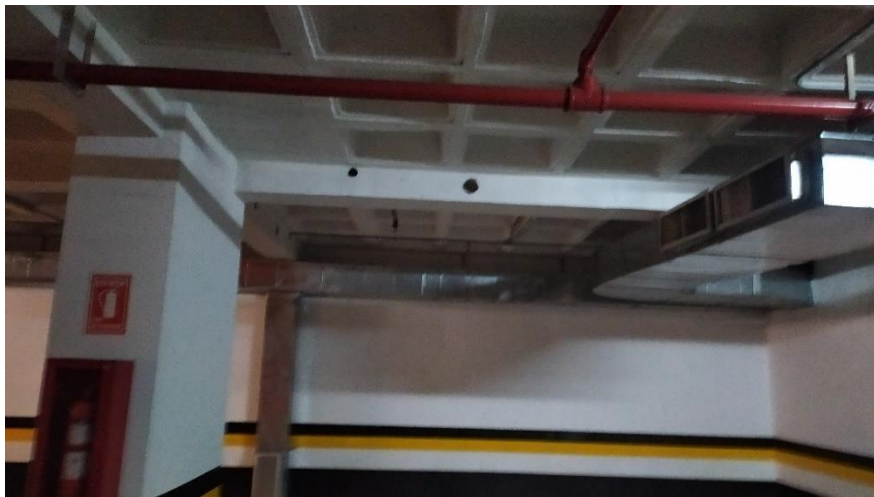
Ilustración 33. Pasantes en vigas sin ser utilizados
