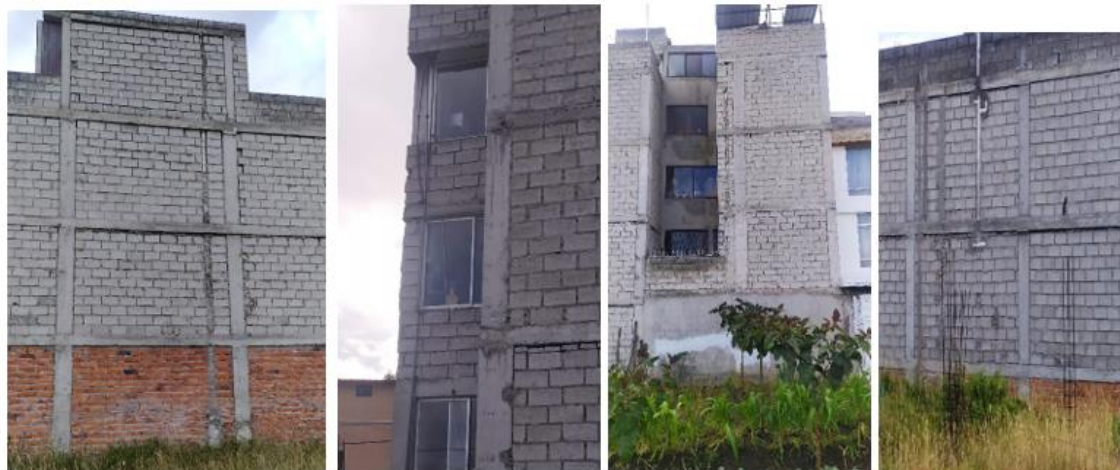
Ilustración 36. Bajantes de Descarga Embebidas en paredes cruzando elementos estructurales
