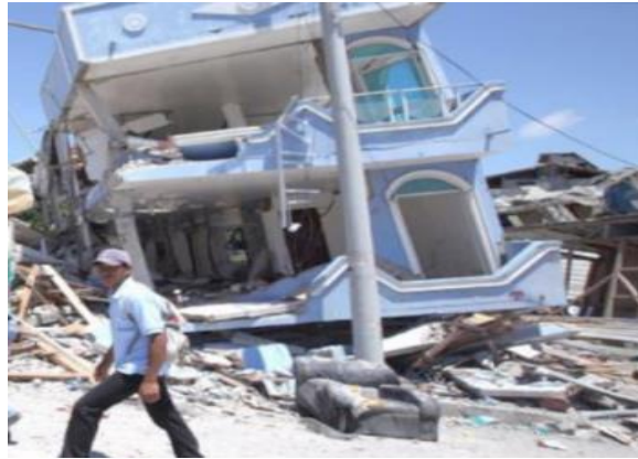
Figura 3.- Edificación dada en el terremoto producido el 16 de abril del 2016.
