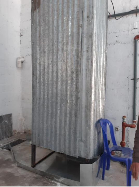
Anexo Figura 7 Torre de enfriamiento de agua
