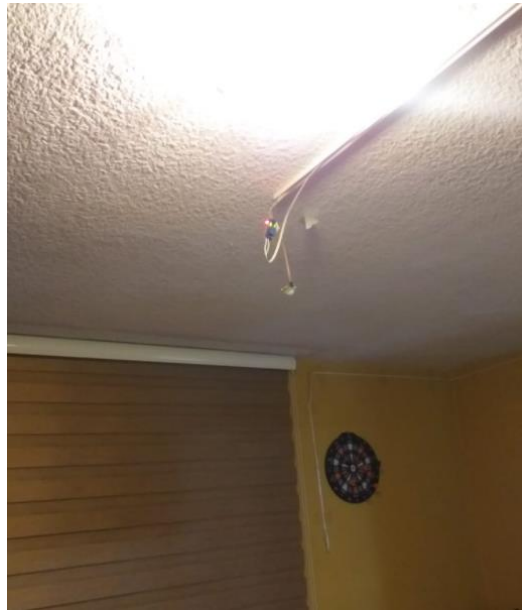
Fotografía sensor y relés seccion1-dormitorio1
