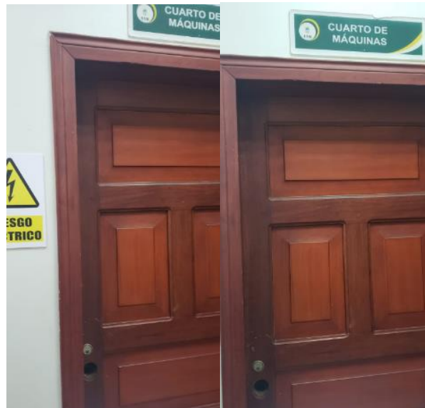
Figura 10: Cuartos de máquinas del GADPS
