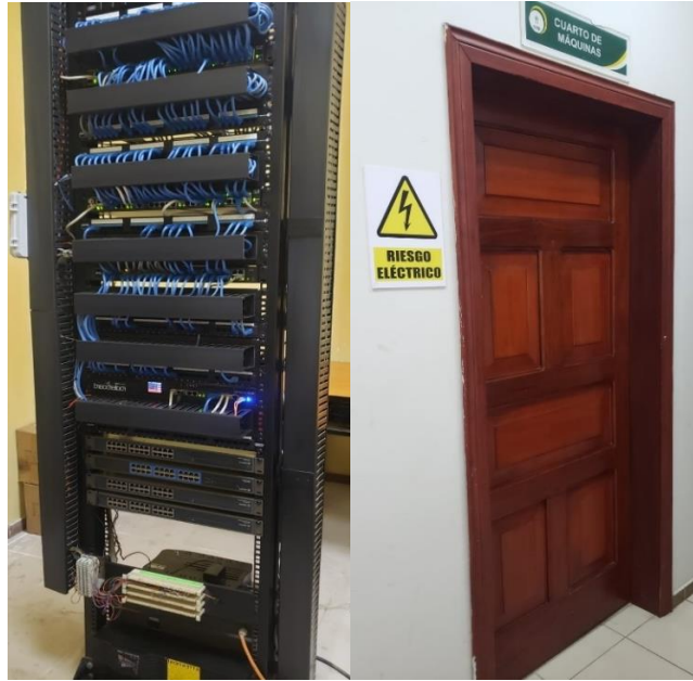
Figura 14: Cuarto de máquinas P1 del GADPS
