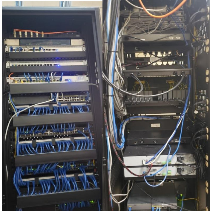
Figura 13: Cableado y conexiones de Racks del Centro de Datos del GADPS
