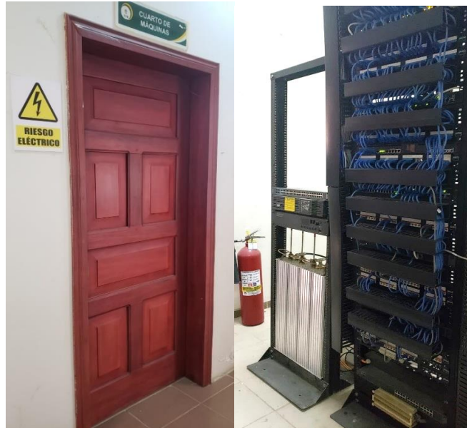
Figura 16: Cuarto de máquinas P3 del GADPS
