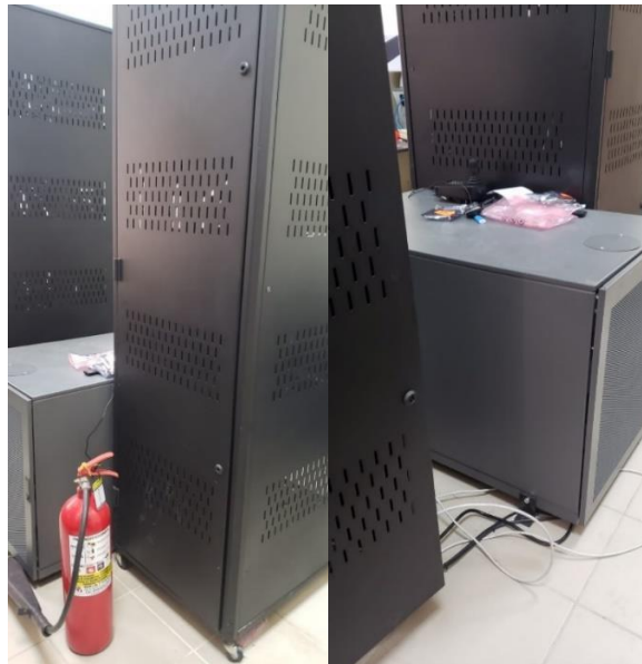
Figura 12: Racks del Centro de Datos del GADPS
