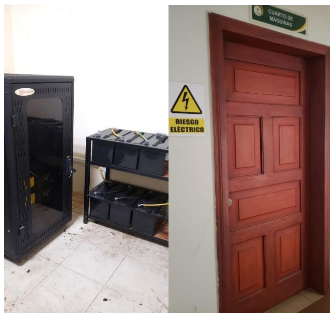
Figura 15: Cuarto de máquinas P2 del GADPS
