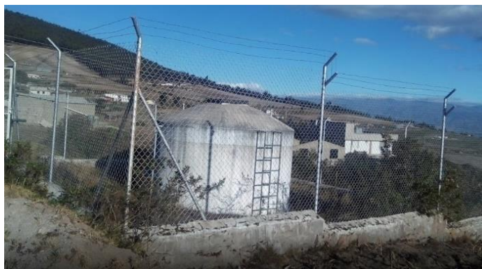
Figura 2.4. Tanque superficial de hormigón armado Fuente: Tanque de Almacenamiento de Uyachul, Pichincha, Quito 2021
