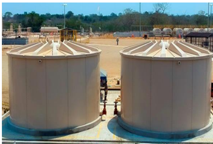
Figura 2.12. Tanque circular de fibra de vidrio. Fuente. Tanque de almacenamiento de agua contra incendios de fibra de vidrio. (Synertech, 2021)
