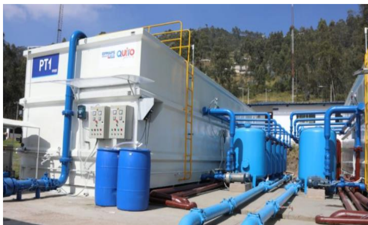
Figura 2.6. Planta de tratamiento de agua potable Conocoto Fuente: Tanque de acero (planta paquete tratamiento de agua potable, Informa 2020)
