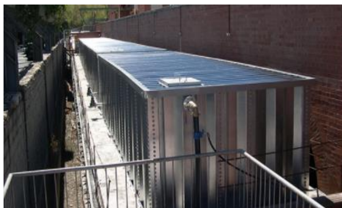
Figura 2.2. Tanque rectangular de láminas de acero inoxidable Fuente: Utilizado para almacenamiento de agua contra incendios (GTS, 2019)
