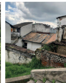
Mal estado edificación Subdivisión de espacios
