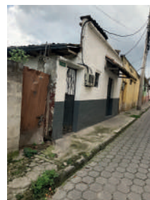
Mal estado edificación
