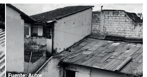
Fuente: Autor Viviendas con malas condiciones de habitabilidad
