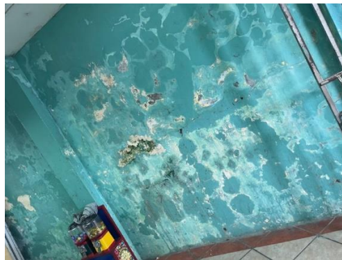
Ilustración 18: Presencia de humedad en la mampostería de la edificación.
