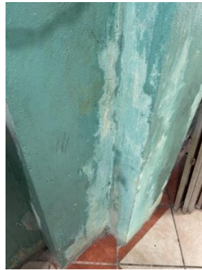
Ilustración 17: Presencia de agentes patógenos producidos por humedad.
