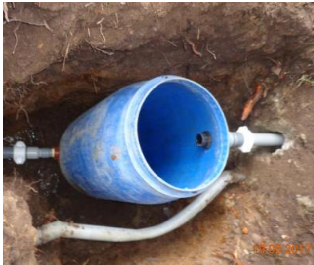
Ilustración 7 Filtro de carbón activado en campo.
