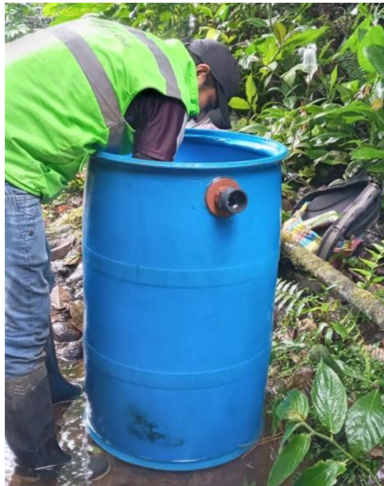
Fotografía N° 21 Ubicación del filtro.
