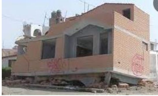
FIGURA 14 Piso blando sismo de pedernales. FUENTE: imagenes+de+piso+blando+sismo+de+pedernales+en+las+construcciones&tbm, 2016.
