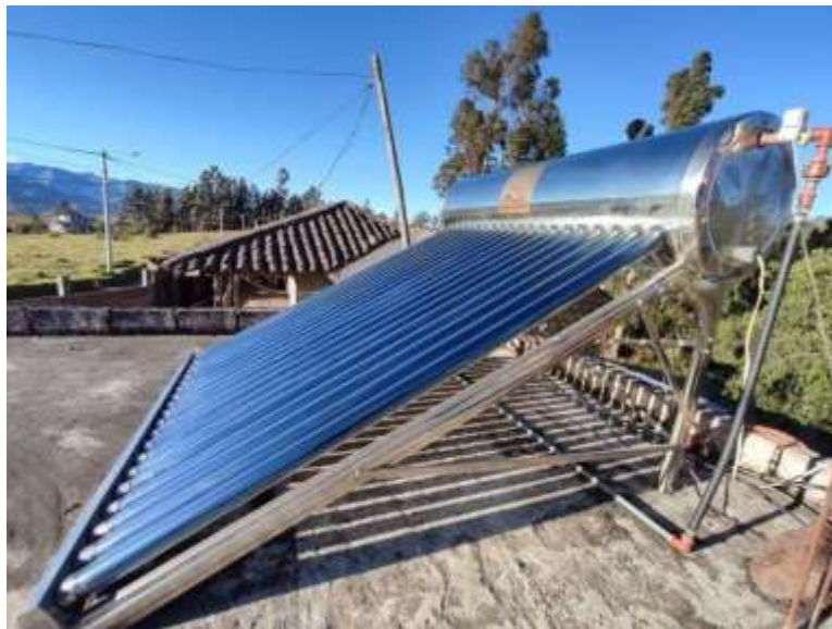
Fig.7. Calentador Solar de Tubos al Vacío con capacidad 200 litros
