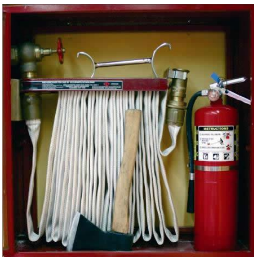
Figura 4 Gabinete contra incendio
