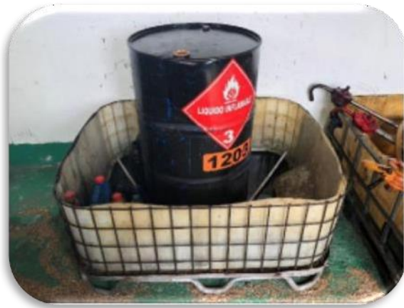
Cubeto de contención
