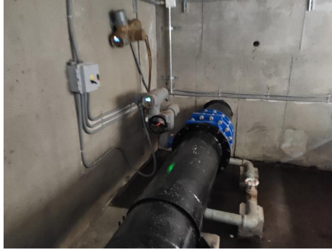
Figura 9: Tubería conectada al sistema SCADA
