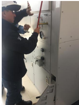
Fuente: Subestación El Inga de Celtec Ep
