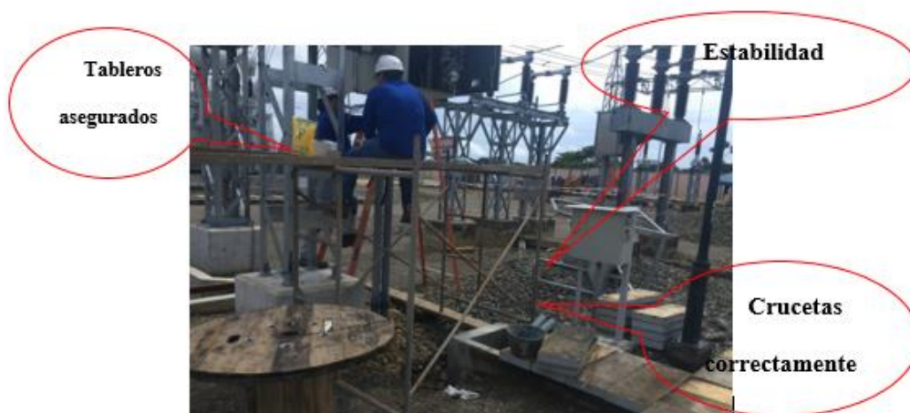
Fuente: Subestación Babahoyo de Celec Ep-Transelectric
