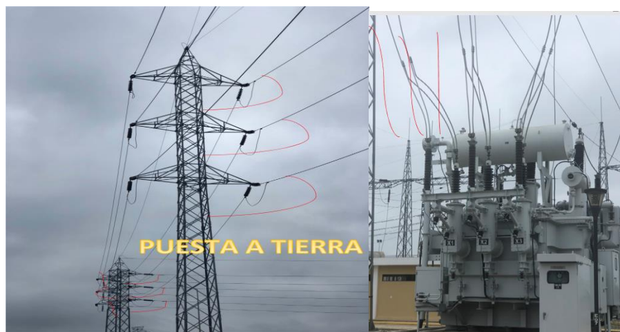
Fuente: Subestación Riobamba de Celec Ep
