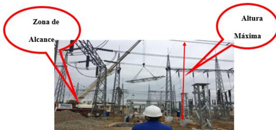
Fuente: Subestación Babahoyo de Celec Ep-Transelectric
