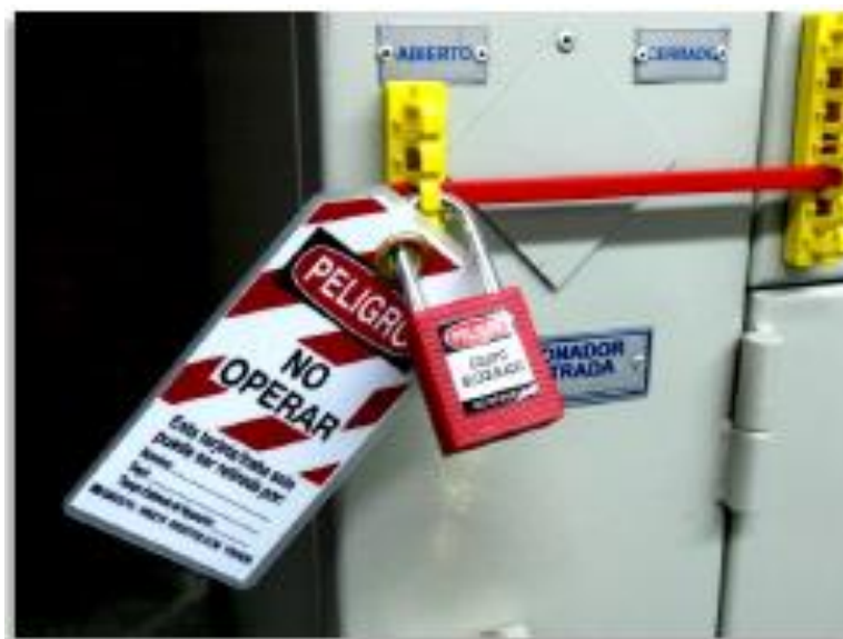
Equipos y Seccionadores bloqueados.
