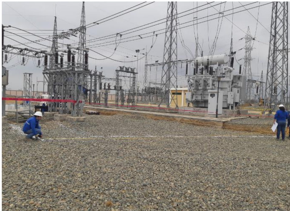
Fuente: Subestación Babahoyo de Celec Ep-Transelectric
