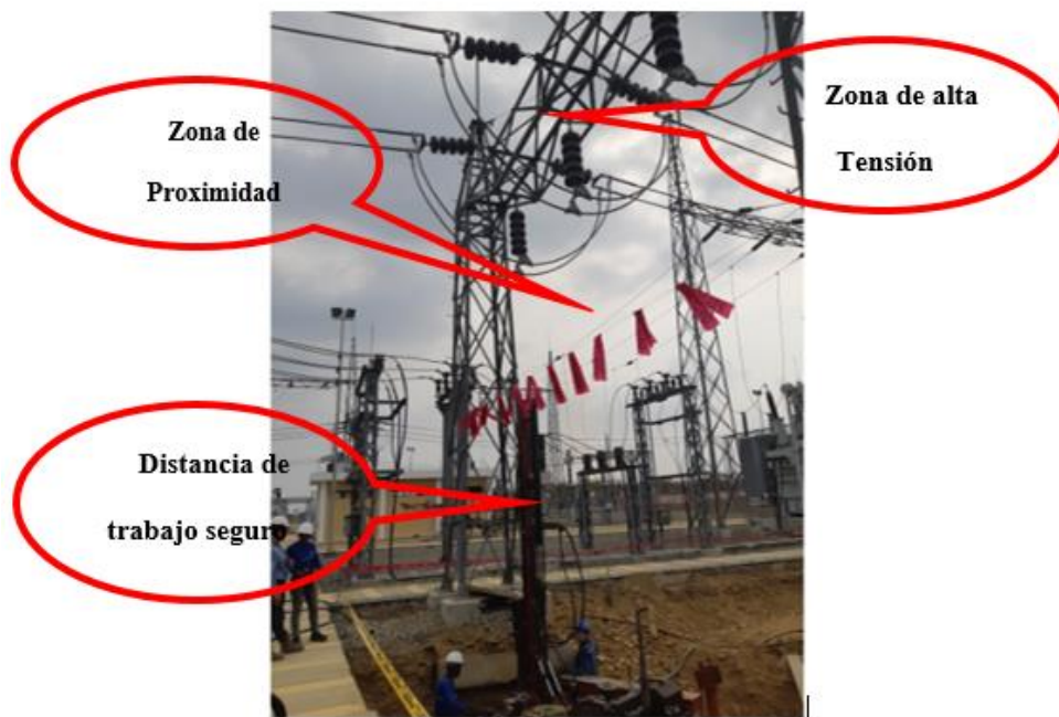
Foto 11. Delimitación con malla roja de zona de alta tensión
