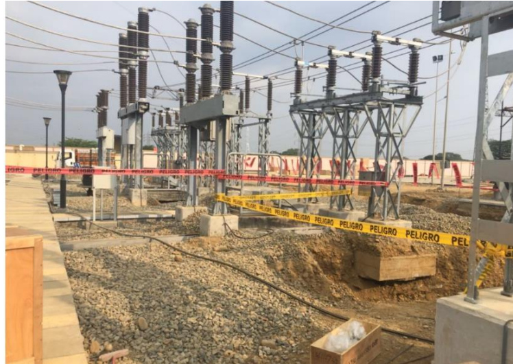
Fuente: Subestación Babahoyo de Celec Ep-Transelectric
