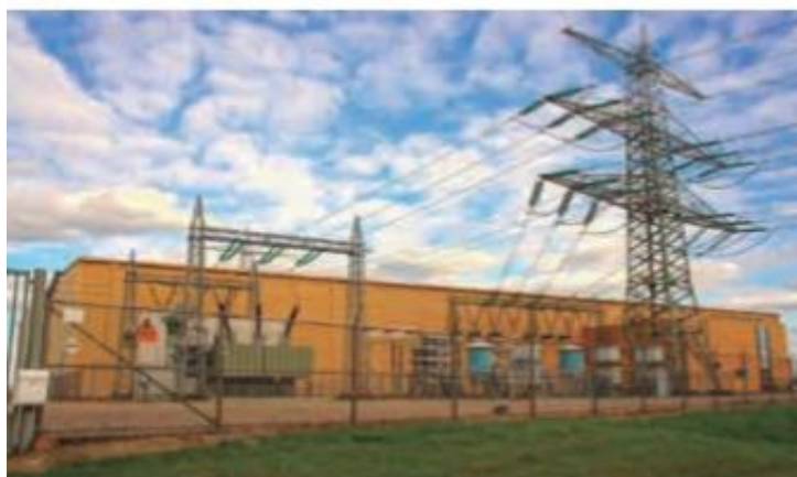
Figura # 17. Subestación de transformación eléctrica
