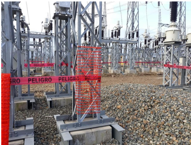
Fuente: Subestación Babahoyo de Celec Ep-Transelectric
