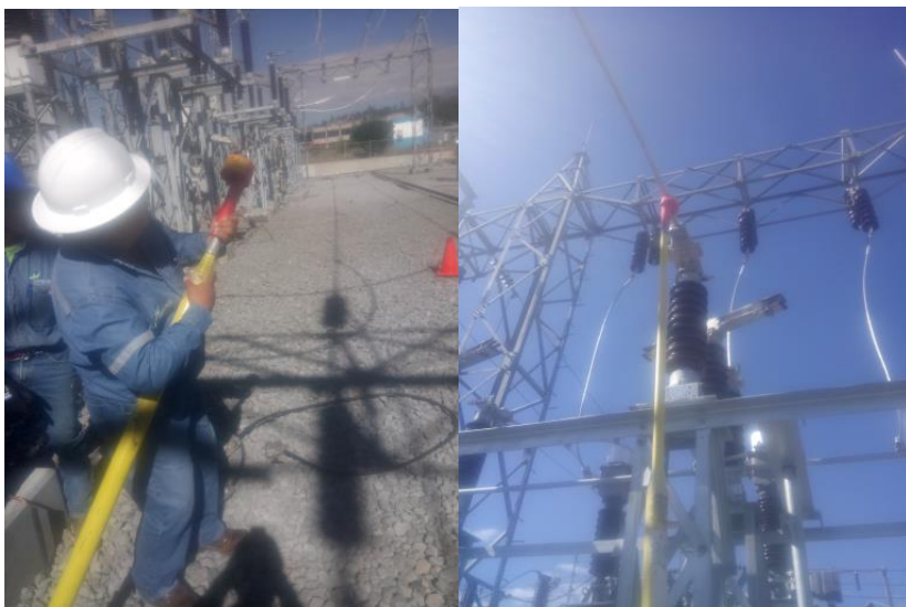
Fuente: Subestación Riobamba de Celec Ep
