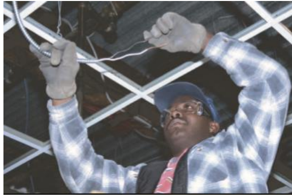
Figura # 5. Seguridad Eléctrica
