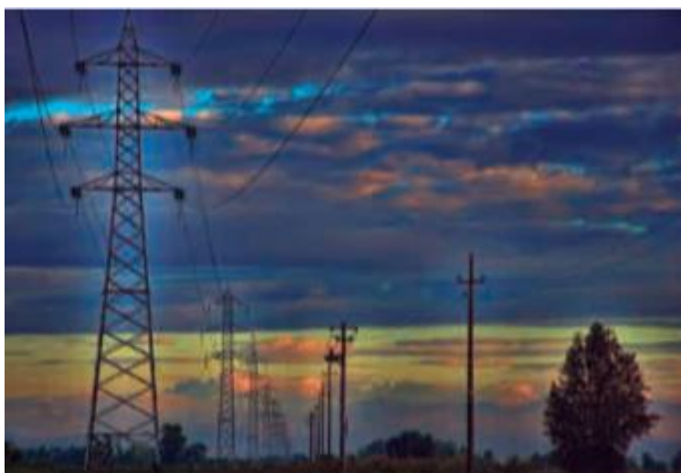
Figura # 16. Líneas eléctricas aéreas
