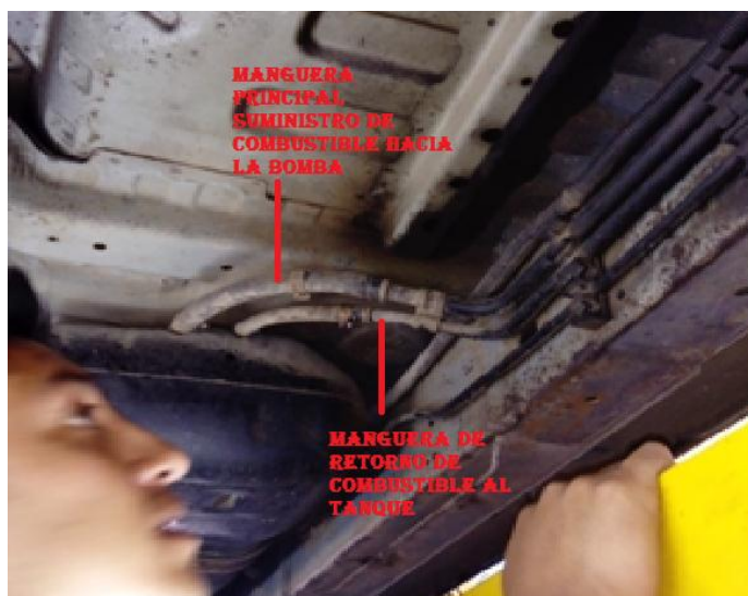
Figura 14. Conexiones de combustible hacia el tanque.
