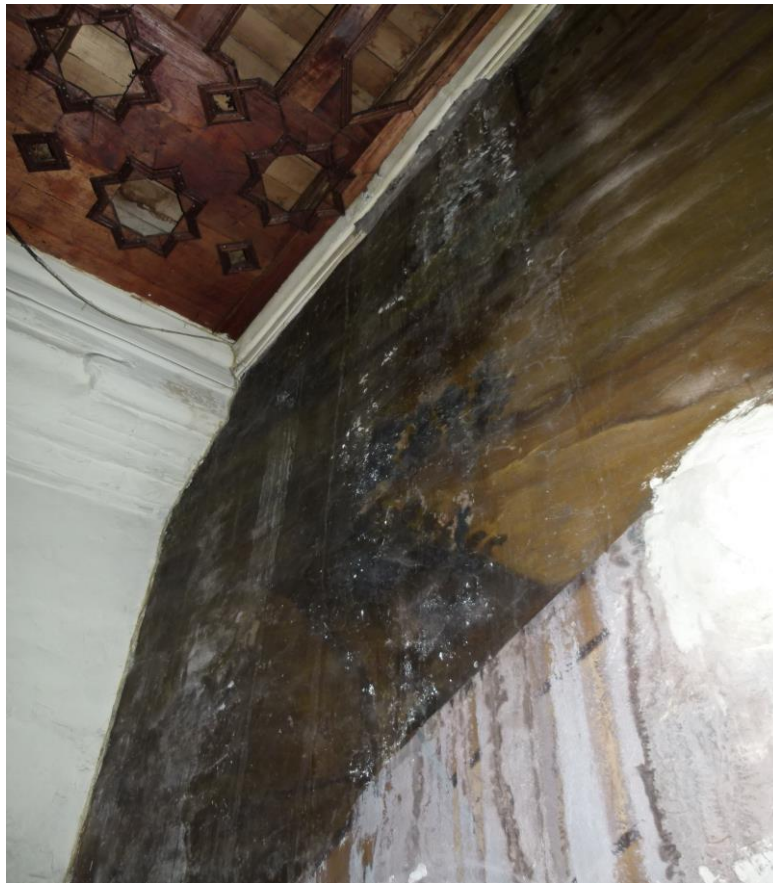
Filtración de humedad/ pintura mural coro alto de la iglesia
