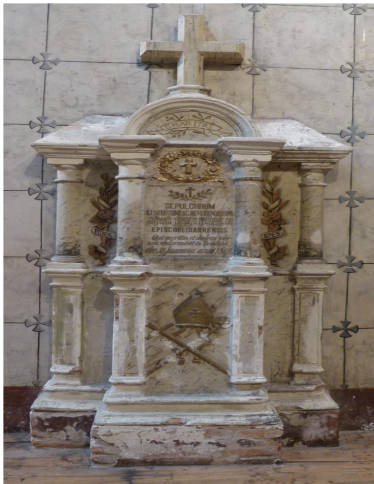
Memorial / vista general del estado de conservación / capilla de las almas
