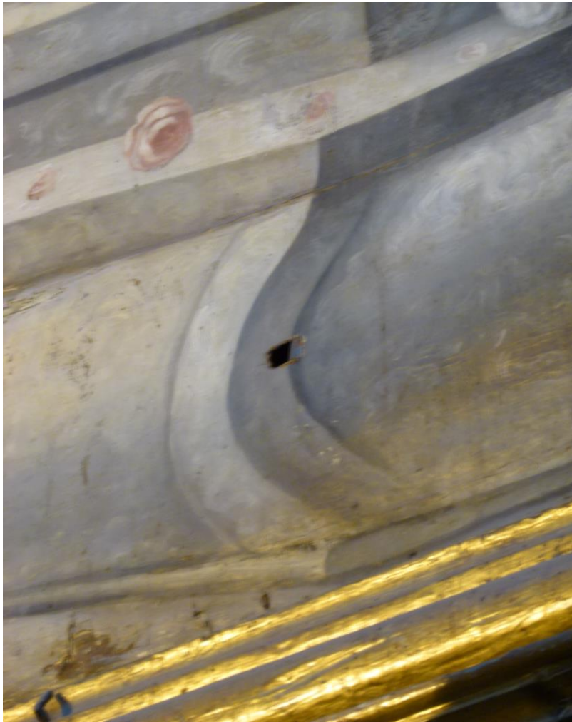
Detalle faltante de soporte / obra Santísima Trinidad
