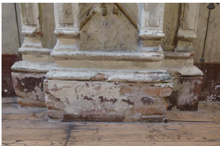
Faltante de soporte / memorial / capilla de las almas.
