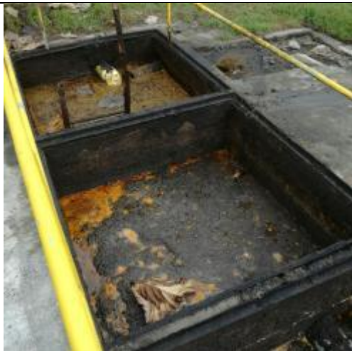
Foto 18: Trampa grasa con presencia de sólidos.
