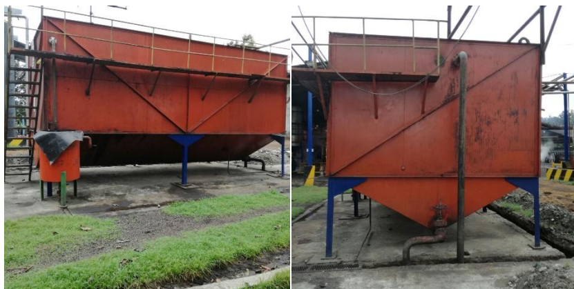
Figura 7. Tanque Florentino de Extranatu S.A.
