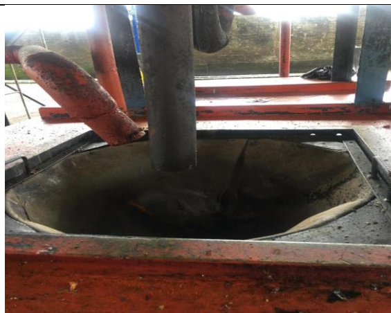
Foto 23: Separación de lodos, agua y aceites en centrífuga
