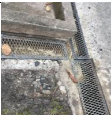
Foto 16: Canal de Efluente hacia ingreso de la PTAR.
