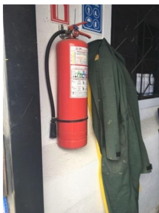
Figura 1.4 Extintor colocado en la bodega de 30m 2 junto a ropa de protección.
