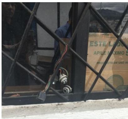
Figura 1.3 Cables sueltos afuera de una de las bodegas.
