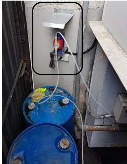
Figura 5. Bomba de dosificación de productos reguladores de pH
