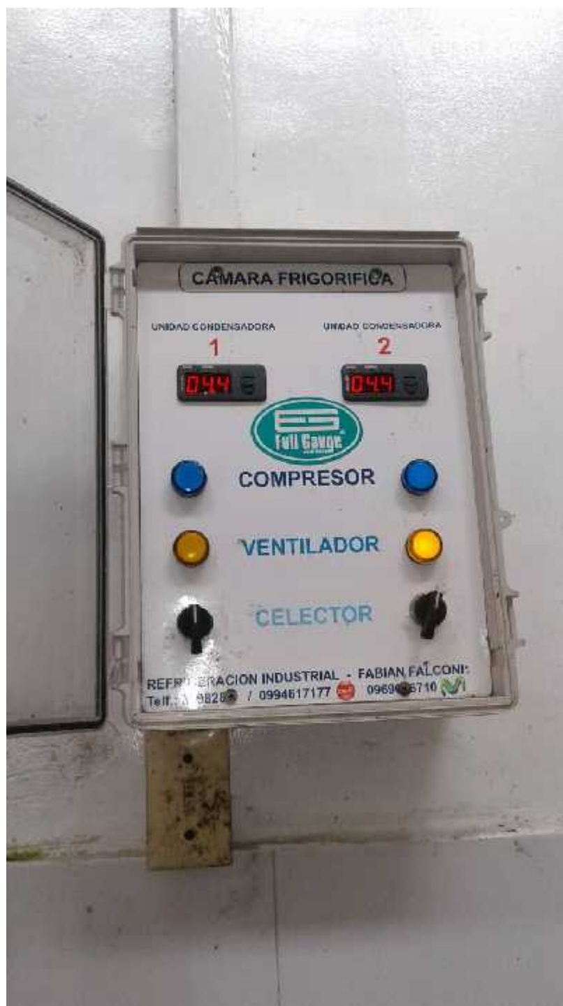
Fotografía 6 – Panel control de cámara refrigeradora
