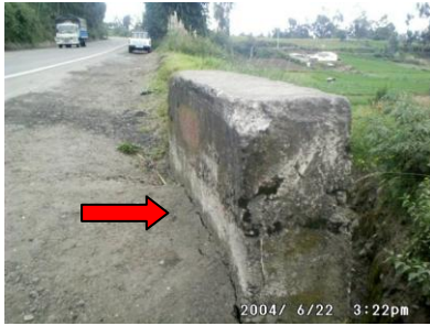
Punto de impacto sobre muro de concreto
