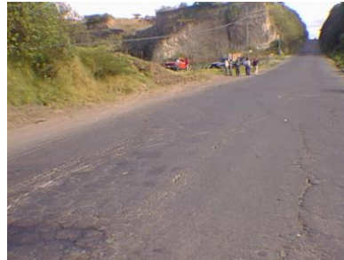
Calzada asfaltada seca irregular (baches).
