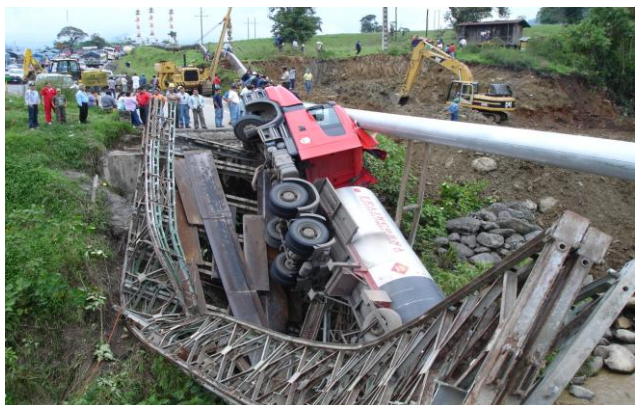
Figura 1. Accidente fortuito por desplome de un puente,
