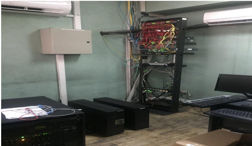
Figura 40 Cuarto de Telecomunicaciones
