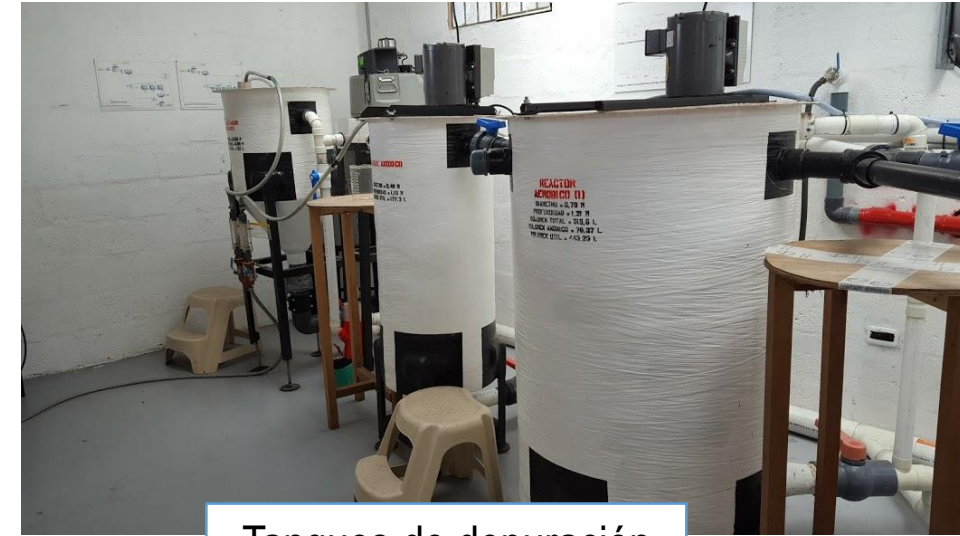
Tanques de depuración
