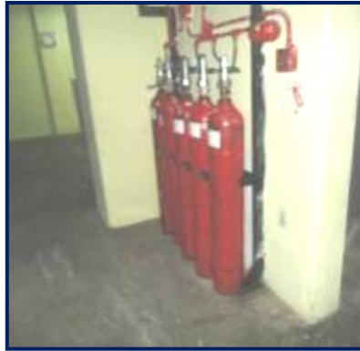
Sistema Descarga CO 2
