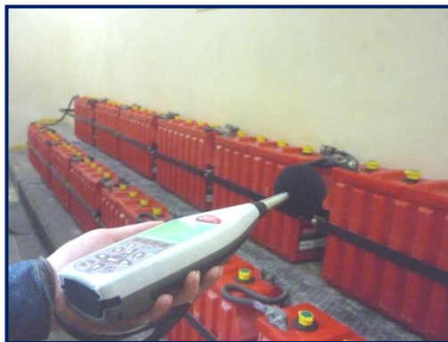
Figura 19: Cuarto de Baterías
