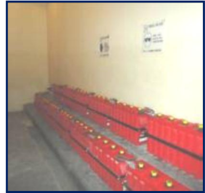
Cuarto de Baterías
