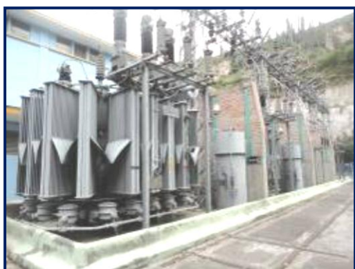
Patio de Elevación 46 KV
