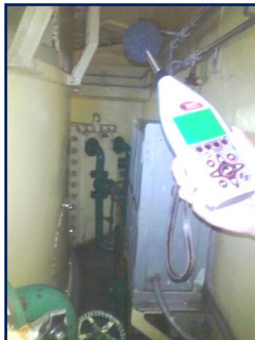
Figura 25: Fosa del Generador
