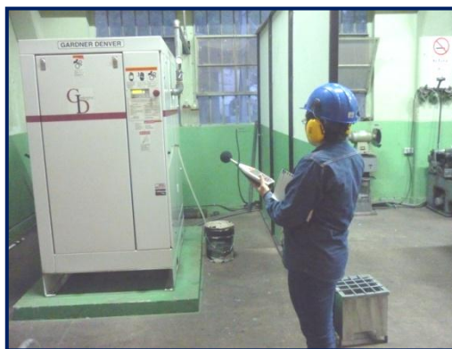
Figura 16: Compresor Área Taller de Mantenimiento
