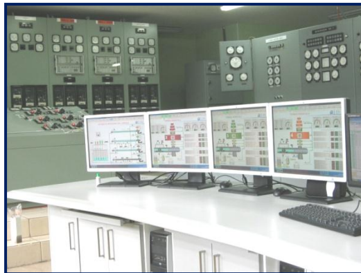
Figura 15: Sala de Control
