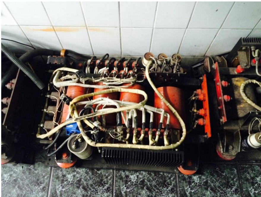
Figura 22. Módulo de transformador de corriente
