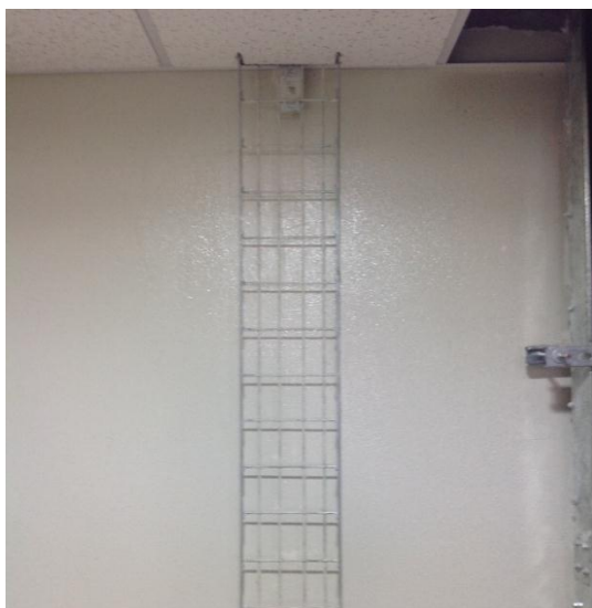
Figura No. 22: Canaletas electrónica y eléctrica PB CEMCP. Elaborado por: Bryan Córdova
