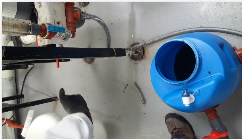
Fuente: (Carcelén Arcos, 2015) Digestor anaerobio de lodos de la PPTAR.
