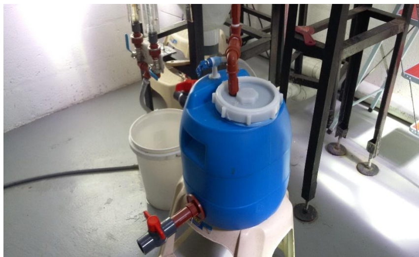
Fuente: (Carcelén Arcos, 2015) Fotografía del digester anaerobio
