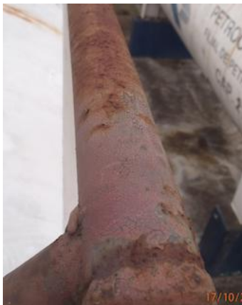
Figura 8. Tubería del Sistema Contra Incendios
