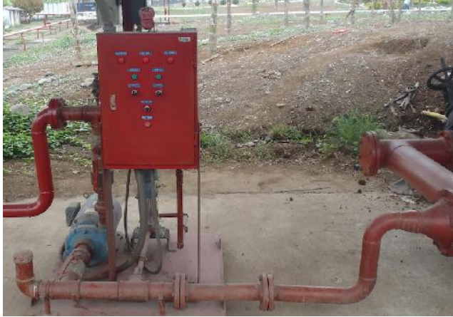
Figura 7. Bomba Contra Incendios
