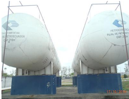
Figura 9. Sistema Actual de Rociadores de Tanques de GLP
