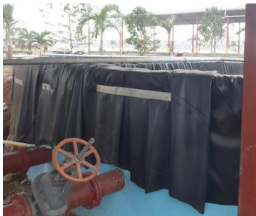
Figura 10. Almacenamiento de agua (Piscina) del Sistema Contra Incendio
