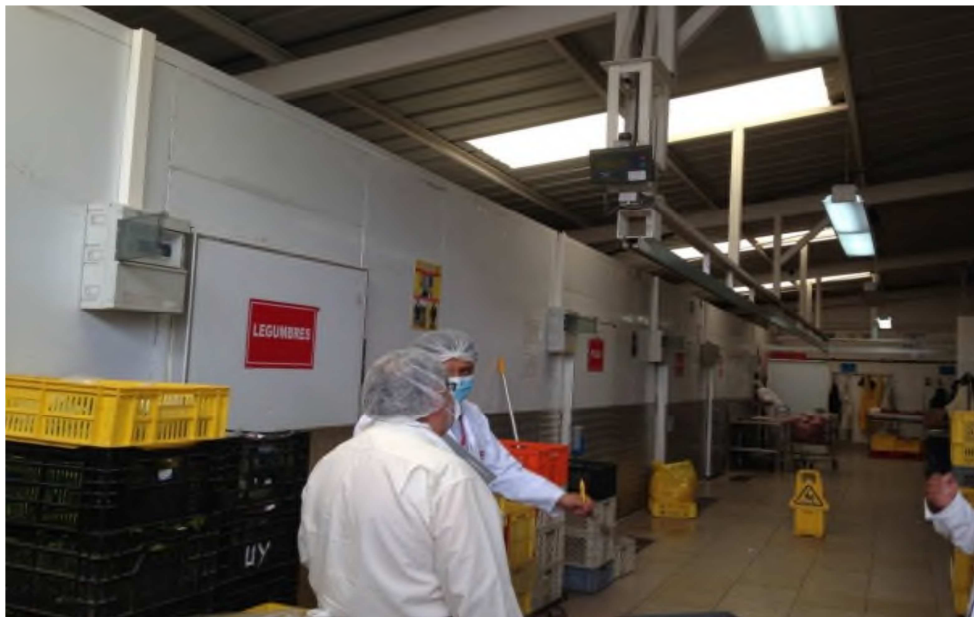
Ilustración 1: Área de almacenamiento- fríos
