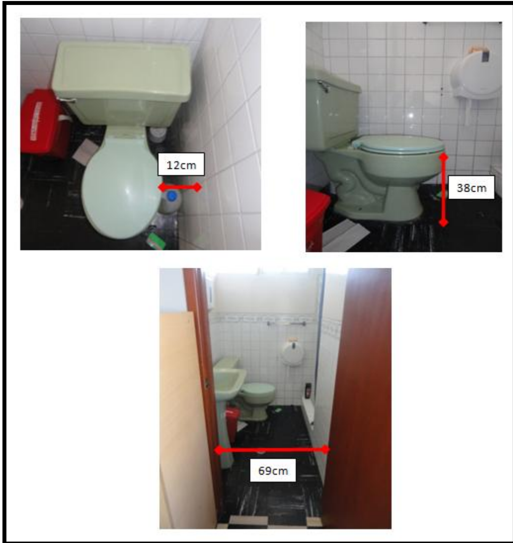
Foto 16. Baño tipo B del Servicio de Hospitalización Realizado por: María Victoria Játiva Almeida Fuente: Servicio de Hospitalización en estudio
