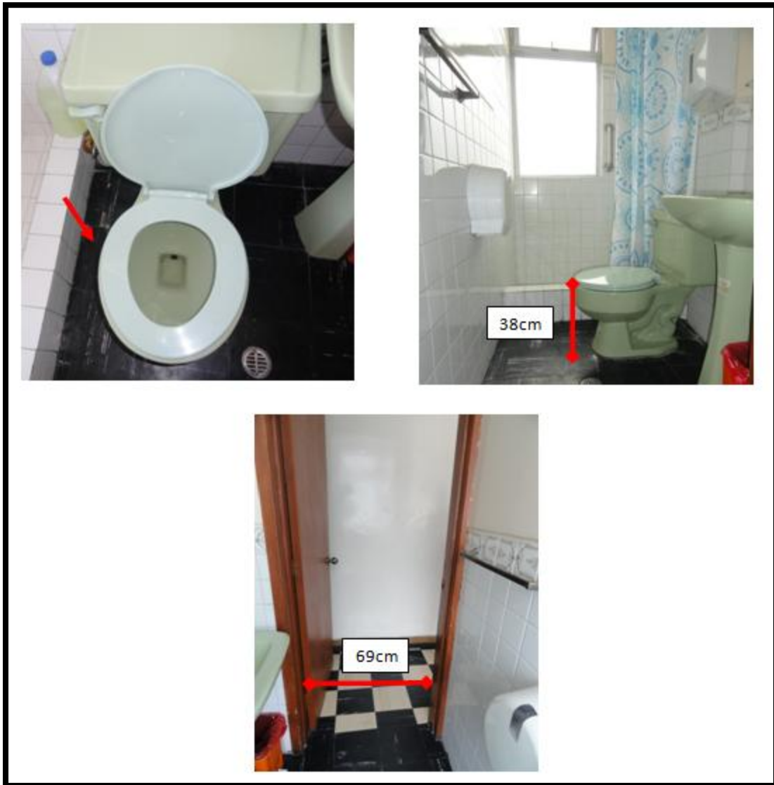
Foto 17. Baño tipo C del Servicio de Hospitalización Realizado por: María Victoria Játiva Almeida Fuente: Servicio de Hospitalización en estudio
