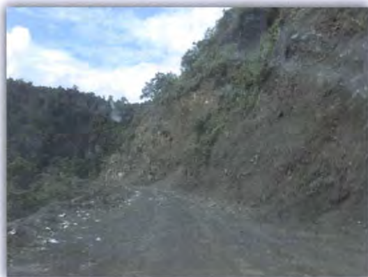
Vía de acceso, de tierra, sin tratamiento ni seguridad Toma: Propia
