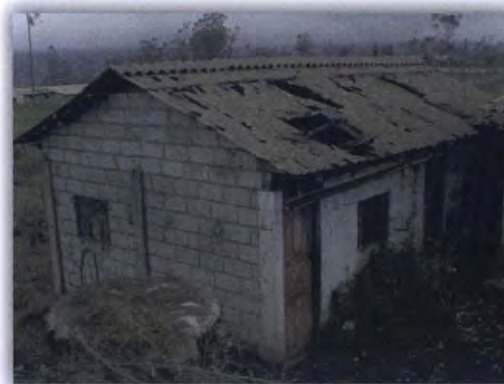
Vivienda destruida y abandonada en la comunidad de San Juan, desde la erupción en el 2006 Toma: Propia
